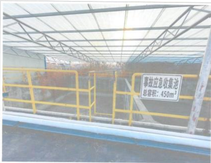
事故应急池照片
